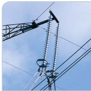
400 kV:n sähkölinjan eristinketju.
