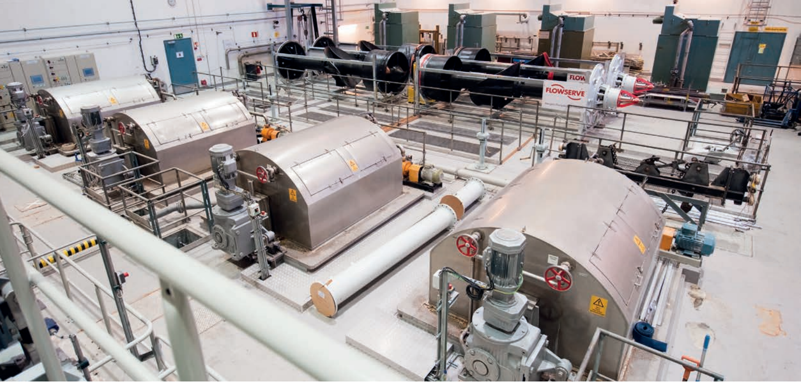
Välppä- ja pumppurakennus
