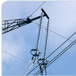
400 kV:n sähkölinjan eristinketju.
