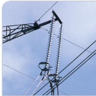
400 kV:n sähkölinjan aristinketju.
